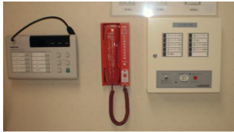
火災通報装置
