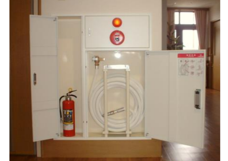
消火器・消火栓
